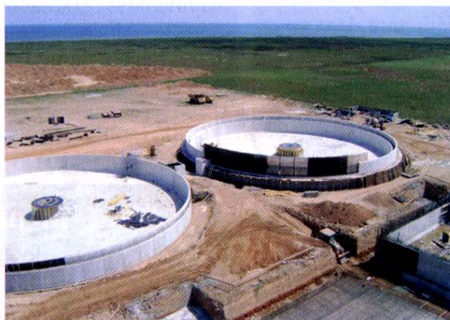
La nouvelle station d'épuration des eaux usées de Nador qui permet entre autres de protéger la lagune de Marchica.
